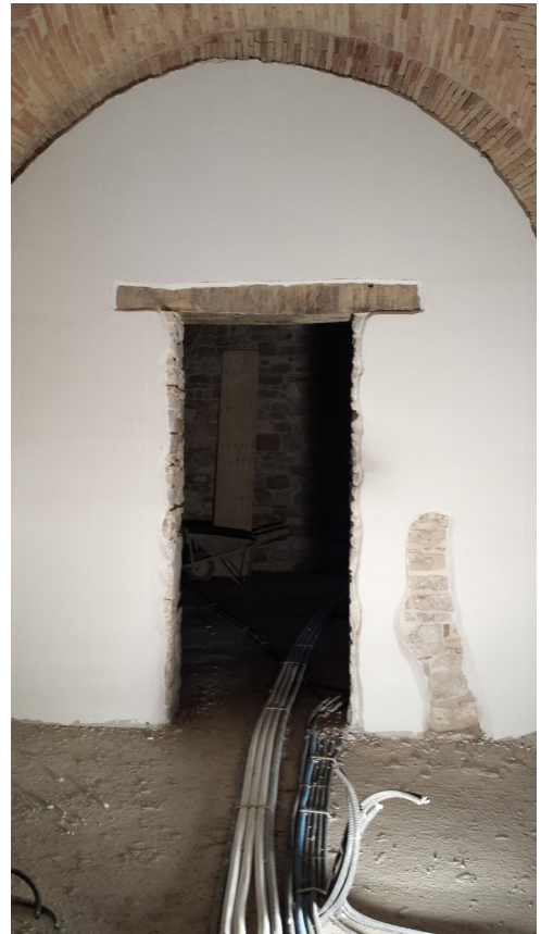
Tubazione a pavimento
