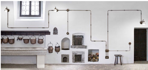
Realizzazione di distribuzione secondaria a vista in treccia
