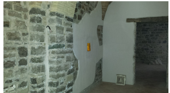
Ripristino muratura in pietrame dopo aver incassato la tubazione anche con intonaco "opus incertum"
