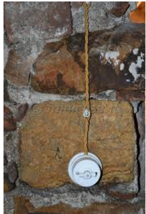
Realizzazione di distribuzione secondaria a vista in treccia
